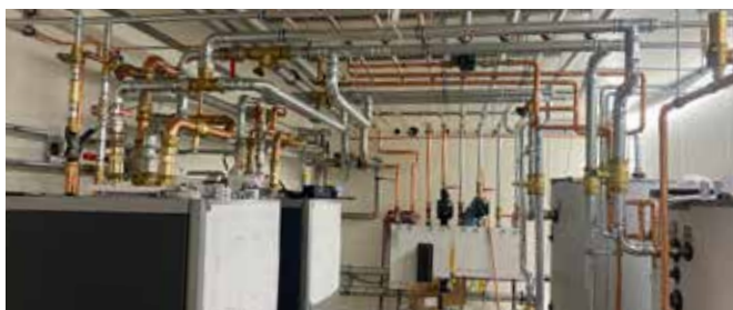
Undercentralen för den nya bergvärmeanläggningen.
